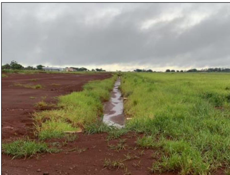
Figura 38: Na região em questão, observa-se a falta de vegetação e uma canaleta de drenagem desprovida de revestimento de cimento.
