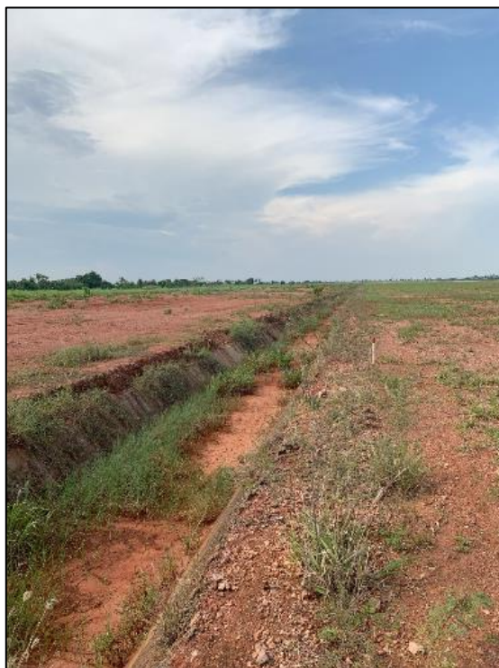
Figura 14: Área com vegetação ausente e uma canaleta de drenagem, na lateral da PPD, onde parte do revestimento de cimento está danificado
