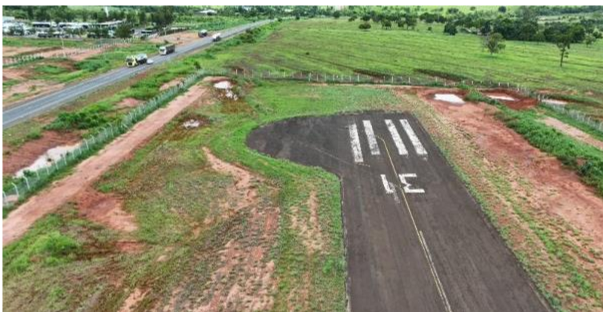
Figura 77: Área sem drenagem das águas das chuvas.
