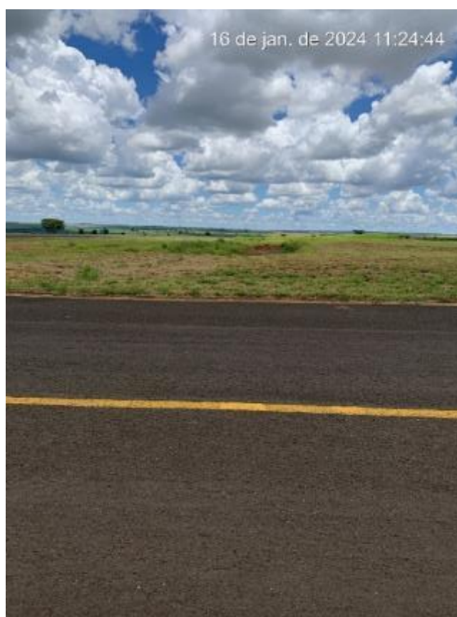
Figura 5-23 - Desnível na pista de táxi do aeródromo municipal de Nova Andradina (MS)
