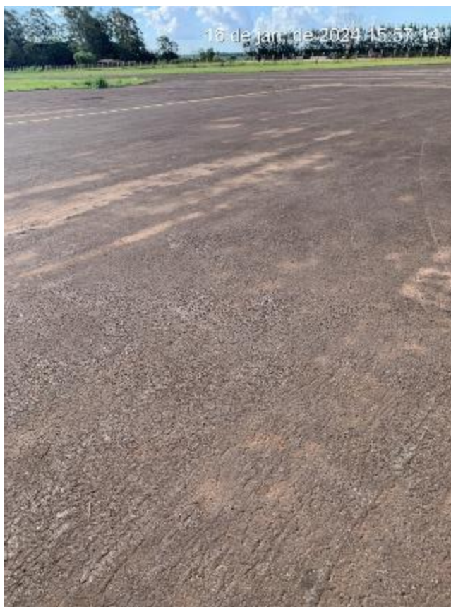
Figura 5-30 - Detalhe da condição do revestimento asfáltico do aeródromo municipal de Nova Andradina (MS)
