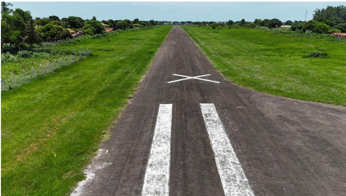
Figura 2-18 - Tomada terrestre da área de giro da PPD do aeródromo de Jardim (MS), com indicação de interdição de pista
