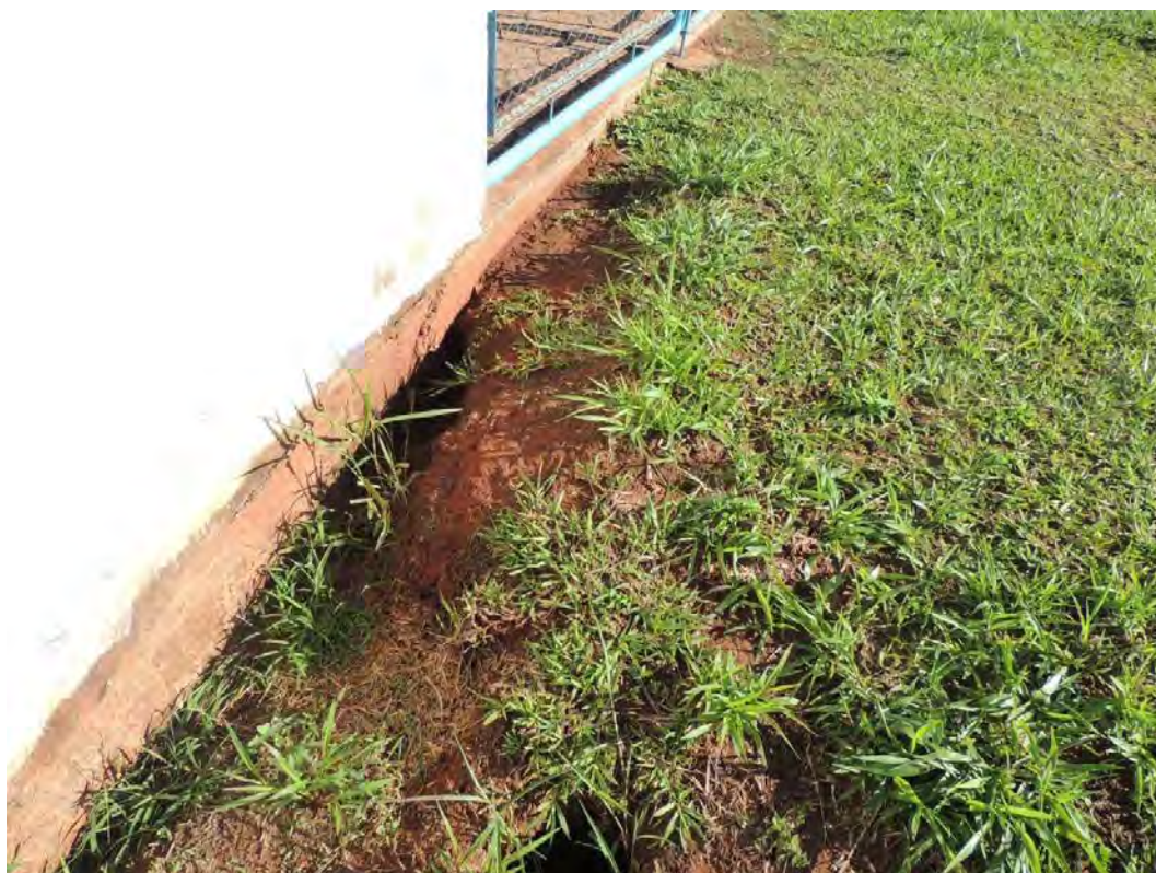
Figura 6: Início de processo erosivo junto ao muro externo da EEEB.
