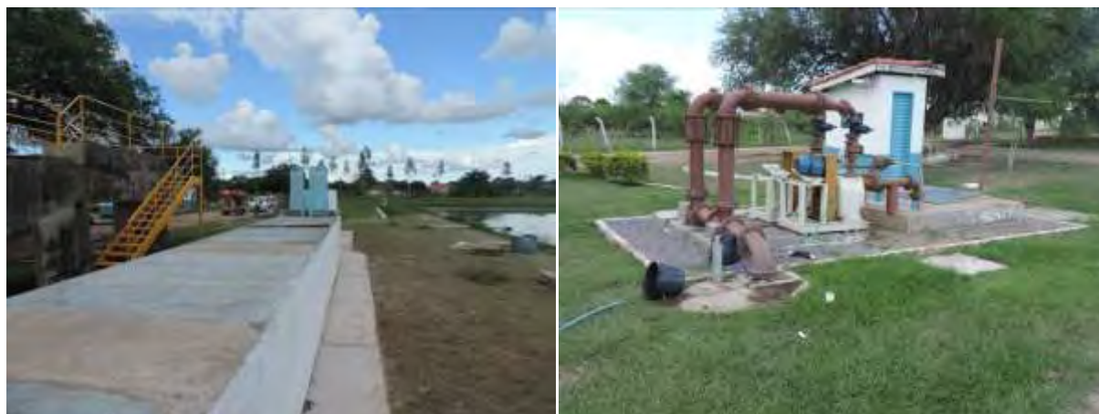
Figura 6: Vista geral da EEEB 001, Porto Murtinho, MS.
