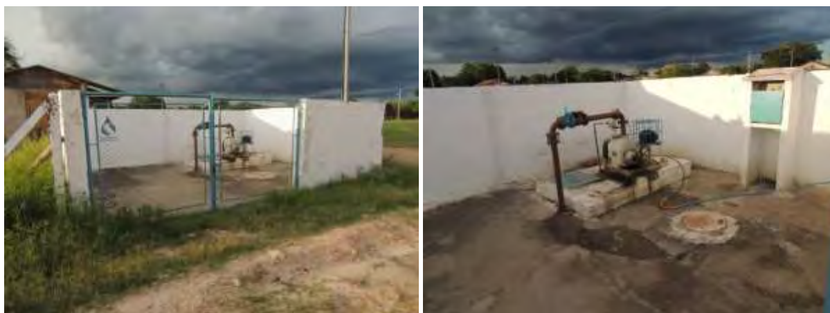
Figura 11: Vista geral da EEEB 006, Porto Murtinho, MS.
