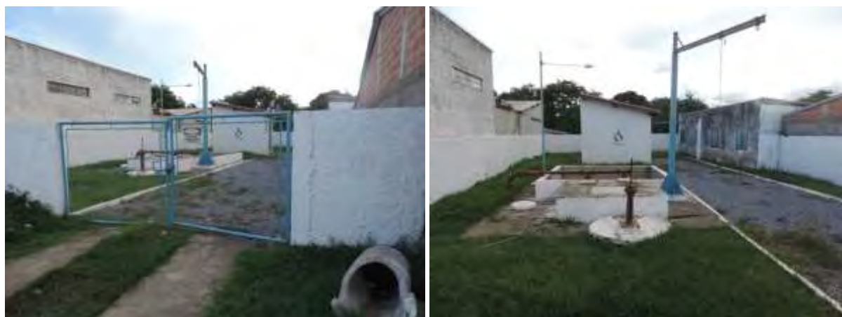
Figura 8: Vista geral da EEEB 003, Porto Murtinho, MS.
