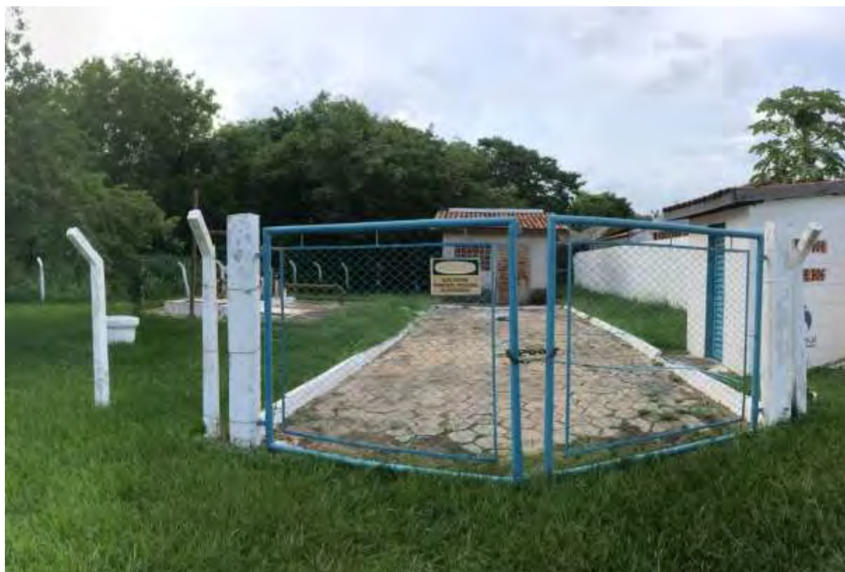
Figura 10: Vista geral da EEEB 005, Porto Murtinho, MS.
