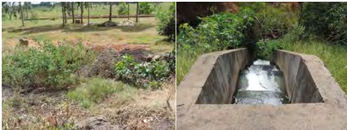
Figura 5: Resíduos sólidos enterrados na área da ETE Iguatemi e emissário no Córrego Sacarón, Iguatemi, MS.
