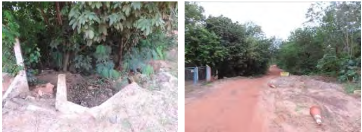
Figura 7: Processo erosivo no entorno da EEEB 009, Coxim, MS.
