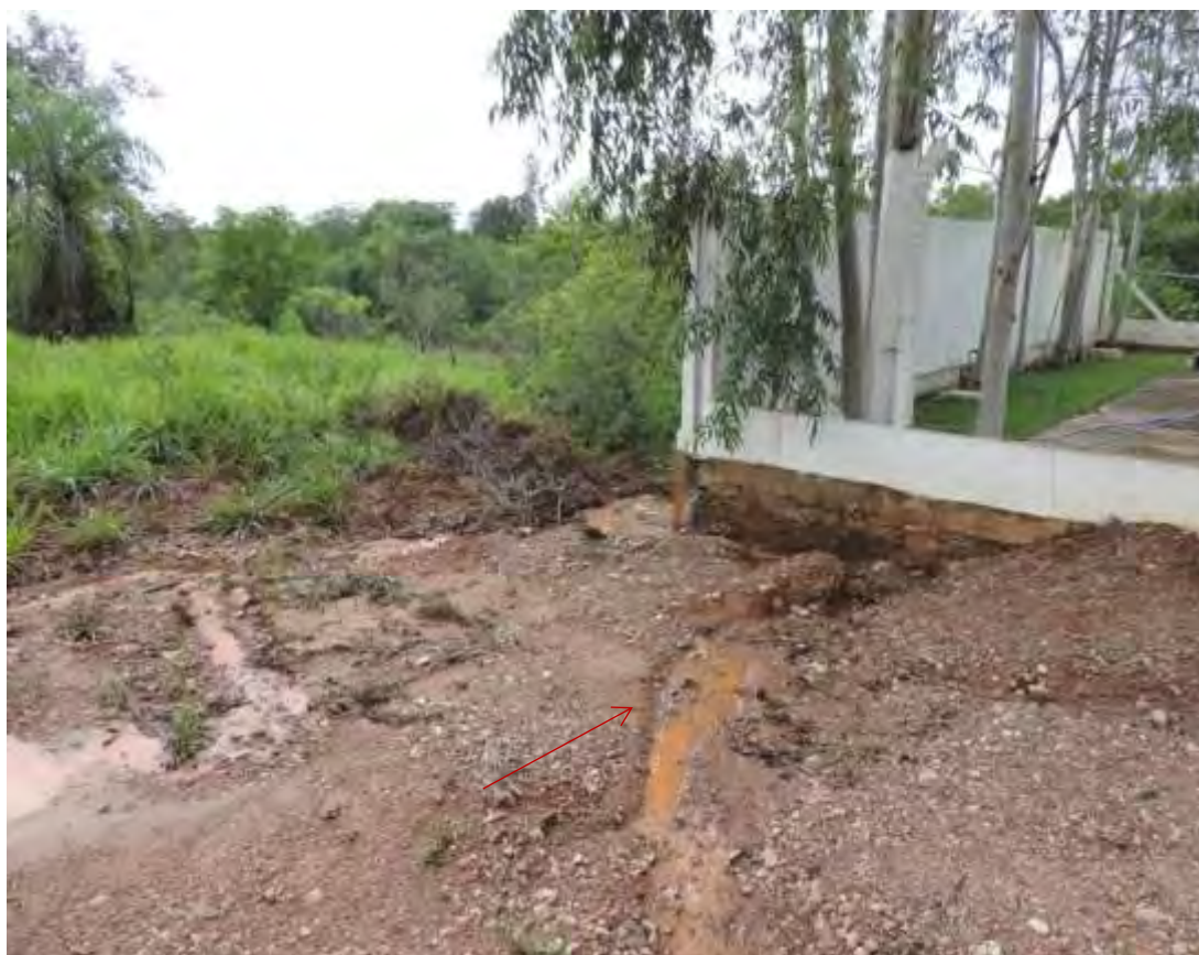
Figura 9: Processo erosivo instalado junto ao muro da EEEB Tarumã I, Bonito, MS.
