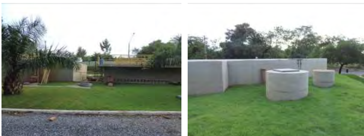
Figura 11: Vista geral da EERL da ETE Bonito, Bonito, MS.
