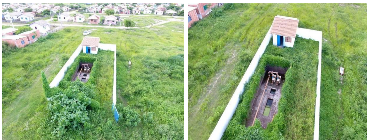
Figura 13: Vista geral da EEEB 008, Porto Murtinho, MS.
