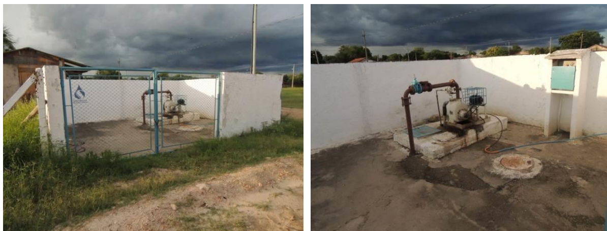
Figura 11: Vista geral da EEEB 006, Porto Murtinho, MS.
