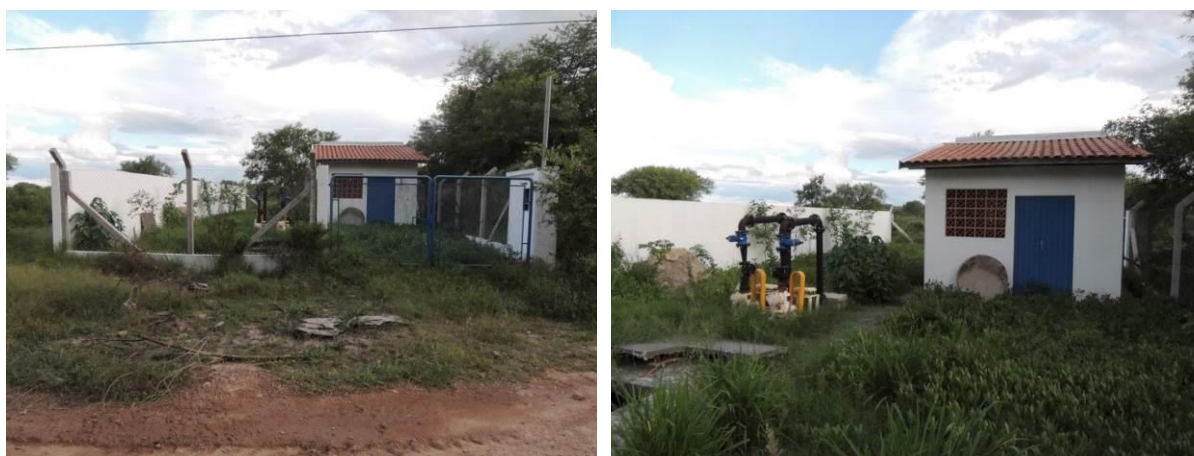
Figura 15: Vista geral da EEEB 010, Porto Murtinho, MS.
