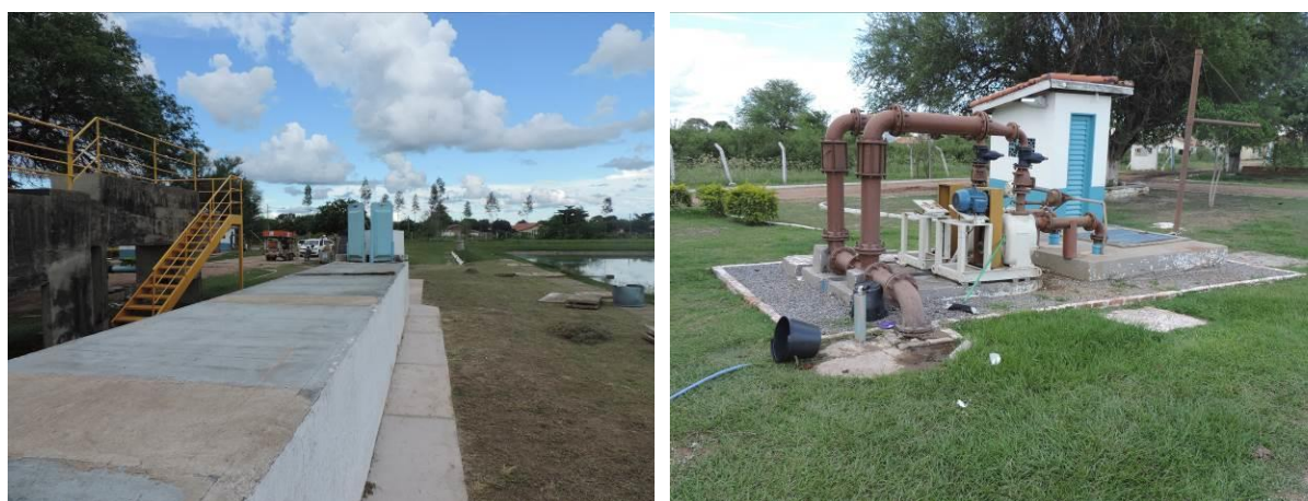
Figura 6: Vista geral da EEEB 001, Porto Murtinho, MS.
