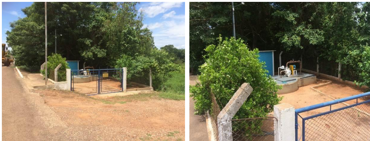
Figura 6: Vista geral da EEEB 004, Miranda, MS.
