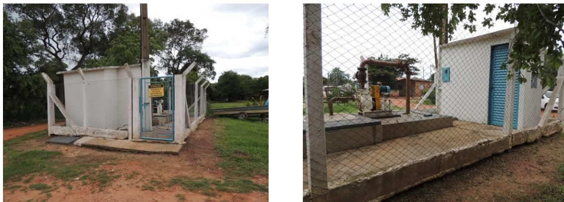
Figura 7: Vista geral da EEEB 003, Miranda, MS.
