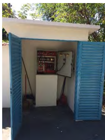
Quadro de comando
