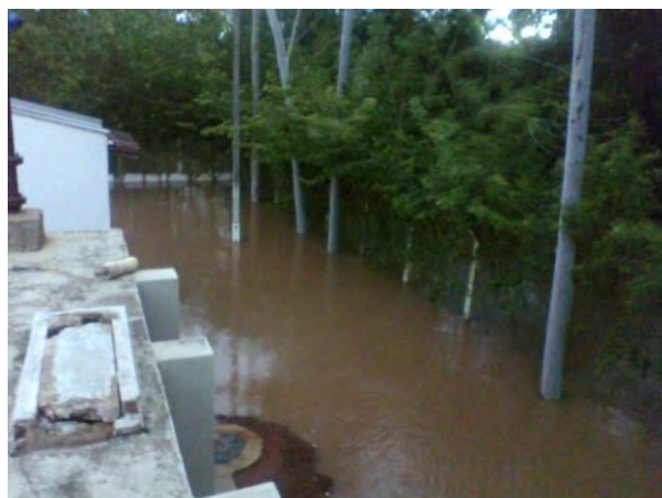
Área lateral da ETE
