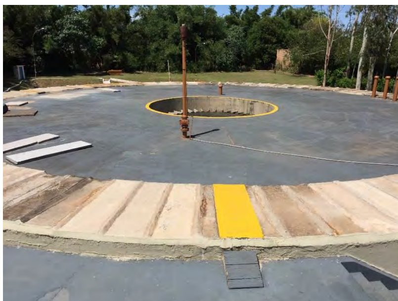
Figura 16: Vista externa do reator RALF
