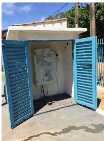
Quadro de comando
