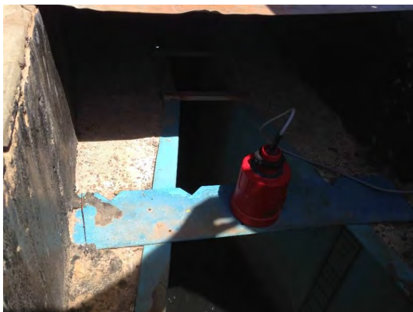
Figura 15: Calha Parshall e medidor ultrassônico
