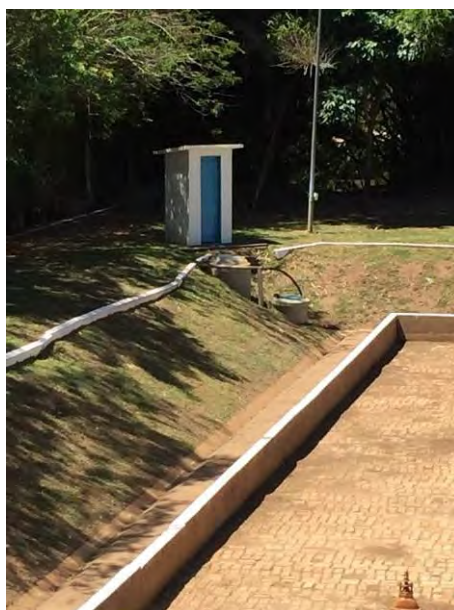
Figura 12: Sistema de drenagem pós - inundação
