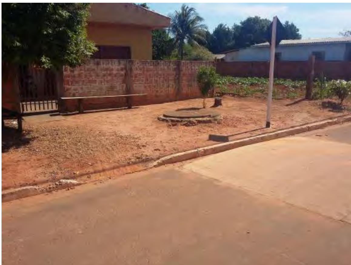
Figura 8: Vista da fossa–sumidouro no passeio, em Taquarussu.
