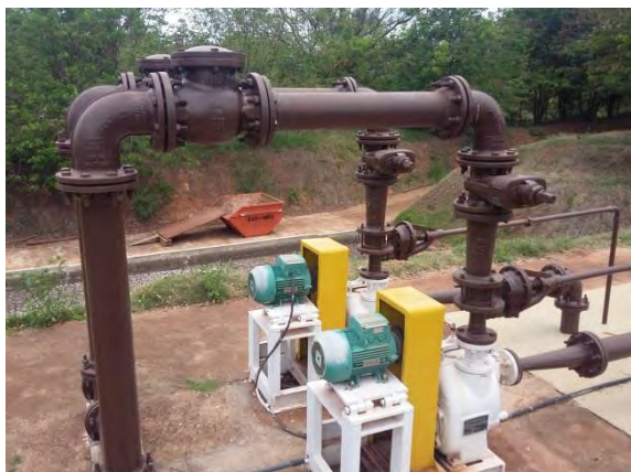
Figura 7: Estação Elevatória de Esgoto Tratado da ETE de Angélica.
