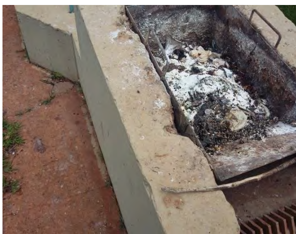
Figura 20: Sólidos retidos no gradeamento da ETE Angélica.
