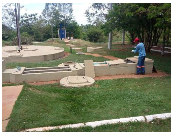
Figura 19: Tratamento Preliminar da ETE Angélica.
