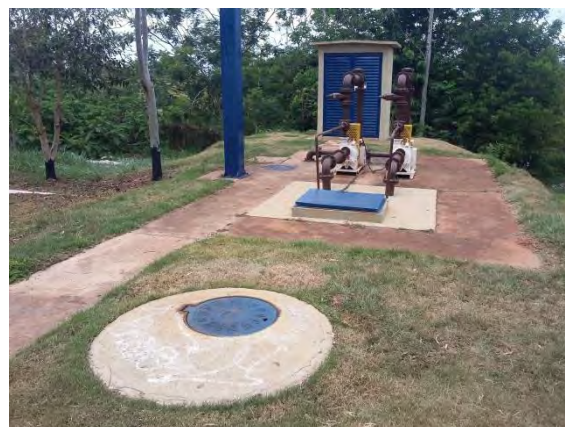
Figura 8: Abrigo do Quadro de comando da estação elevatória EEET da ETE de Angélica.
