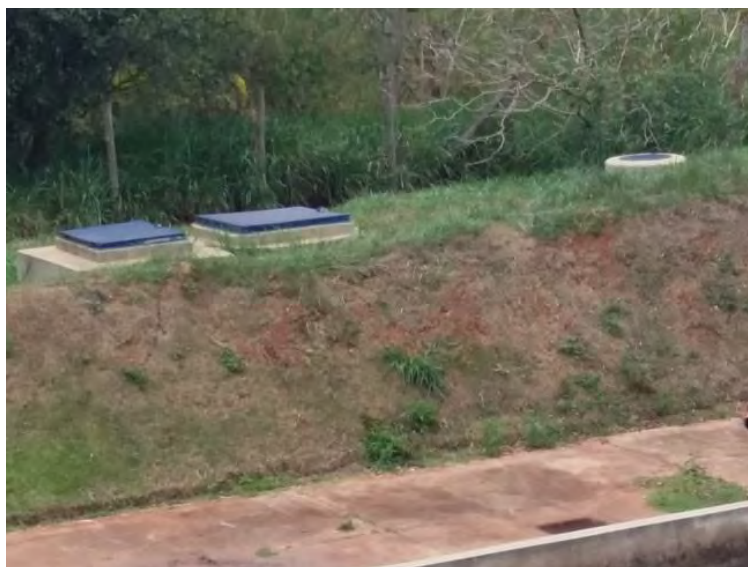
Figura 10: Estação Elevatória de Recirculação de Lodo da ETE de Angélica.
