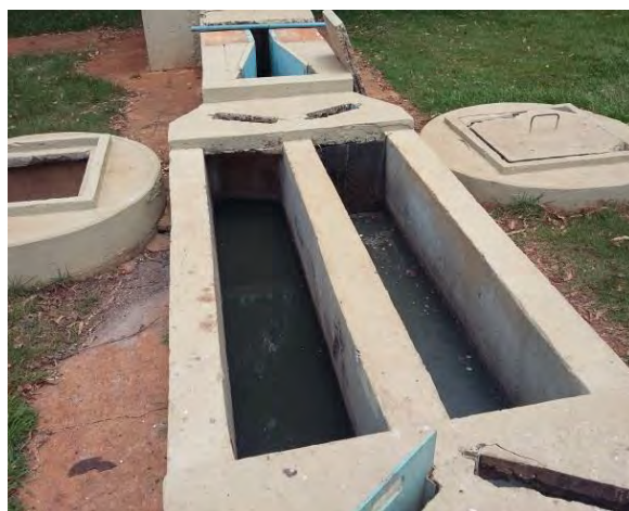
Figura 21: Desarenador da ETE Angélica.
