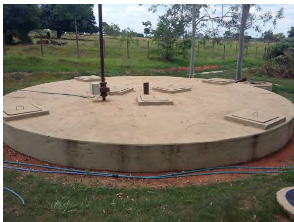
Figura 24: Reator UASB/RALF da ETE Angélica.
