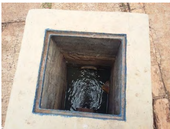
Figura 18: Chegada de esgoto bruto na caixa de entrada da ETE Angélica.
