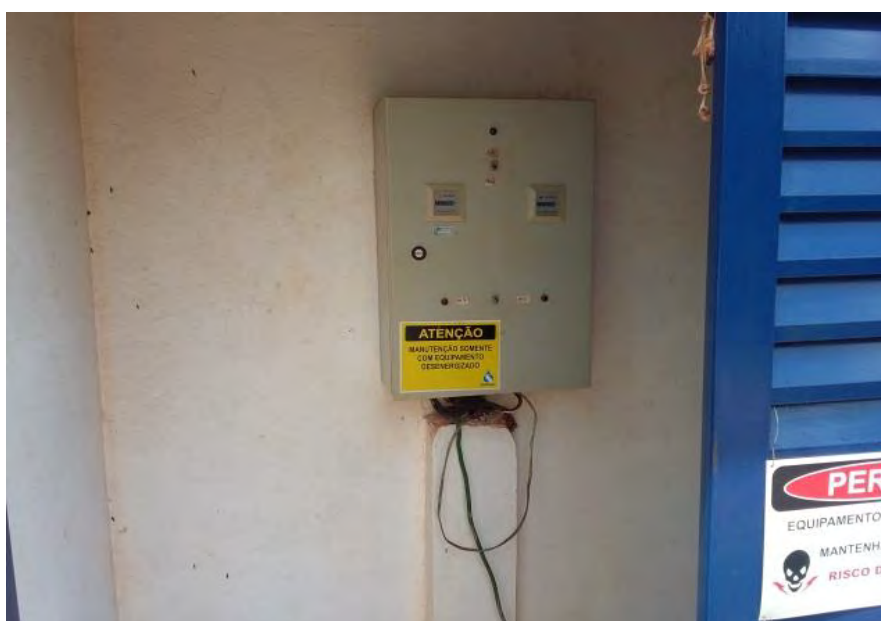
Figura 9: Quadro de comando da estação elevatória EEET da ETE de Angélica.
