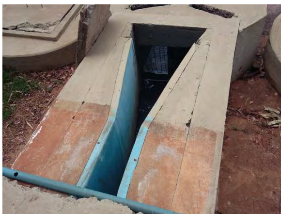
Figura 22: Calha Parshall w=6" da ETE Angélica.
