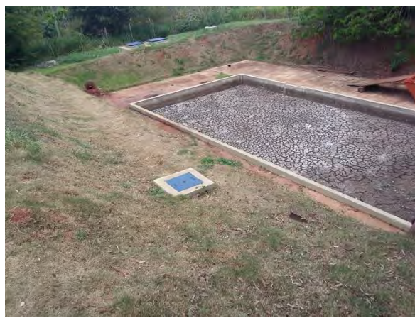
Figura 27: Vista 2 do Leito de Secagem da ETE Angélica.
