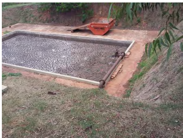
Figura 26: Vista 1 do Leito de Secagem da ETE Angélica.
