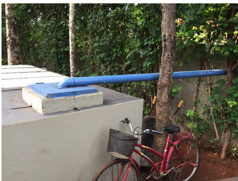
Figura 11: Caixa de recepção de caminhão Limpa Fossa.
