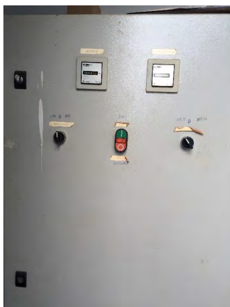
Quadro de comando
