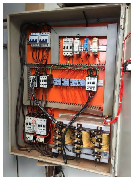
Quadro de comando (Vista interna)
