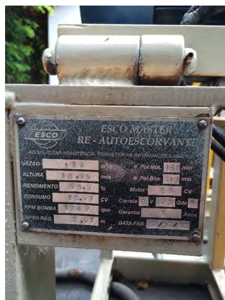
Placa de identificação da bomba
