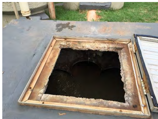
Caixa de passagem
