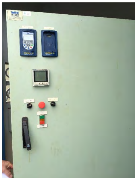
Quadro de comando
