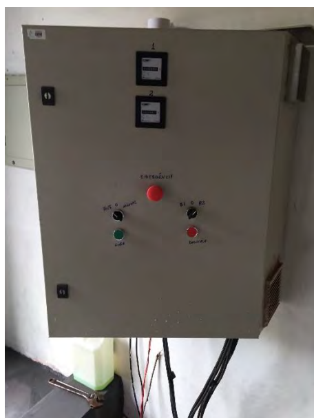
Quadro de comando
