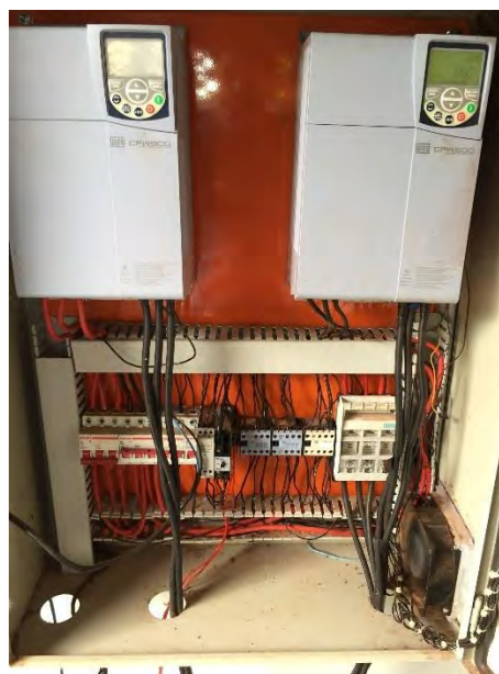
Quadro de comando (Vista interna)
