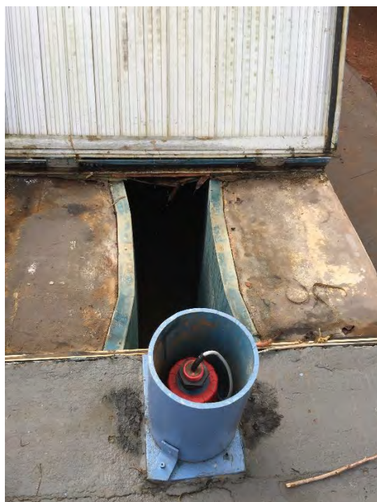
Calha Parshall com medidor ultrassônico
