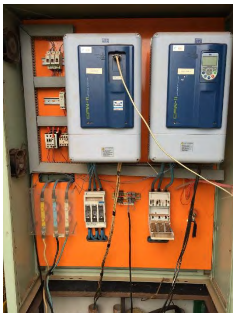
Quadro de comando (Vista interna)
