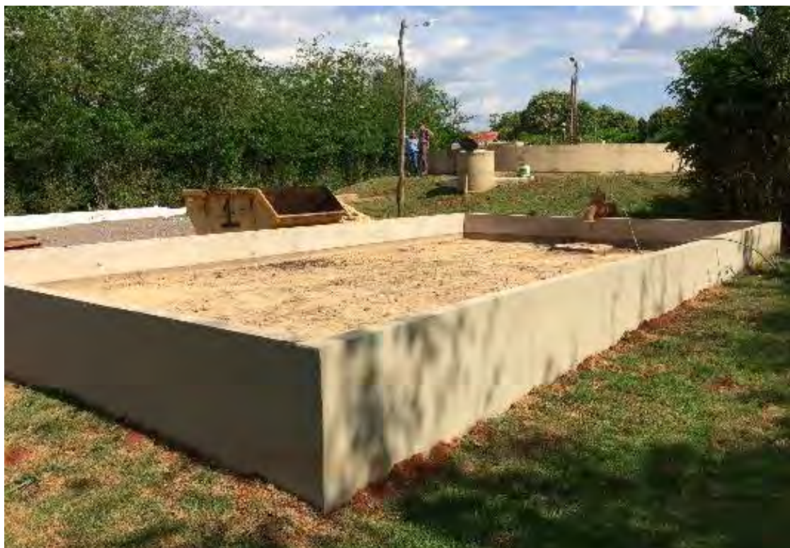
Figura 17: Leito de secagem de lodo da ETE Nioaque.
