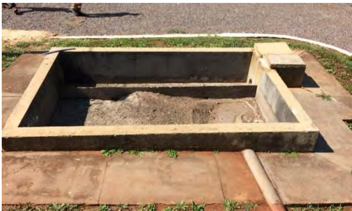
Figura 15: Caixa de areia para descarga de resíduos do desarenador da ETE Nioaque.
