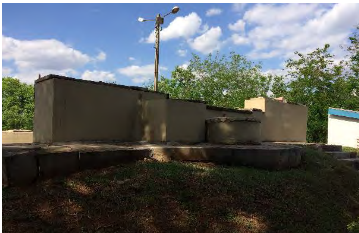
Figura 14: Vista do tratamento preliminar (desarenador) da ETE de Nioaque.
