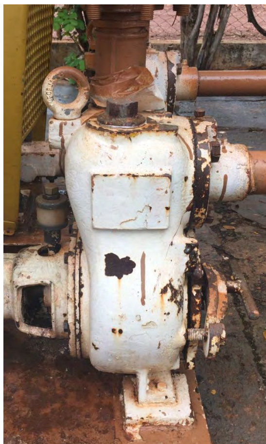
Detalhe do processo de oxidação do conjunto motobomba
