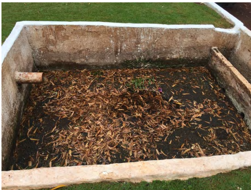
Figura 11: Caixa de areia
