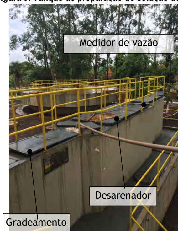
Figura 10: Tratamento preliminar ETE Maracaju
