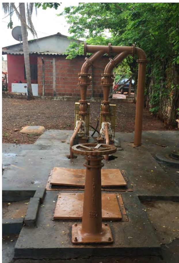
Vista do gradeamento, poço de sucção, conjuntos motobomba e barrilete de recalque
