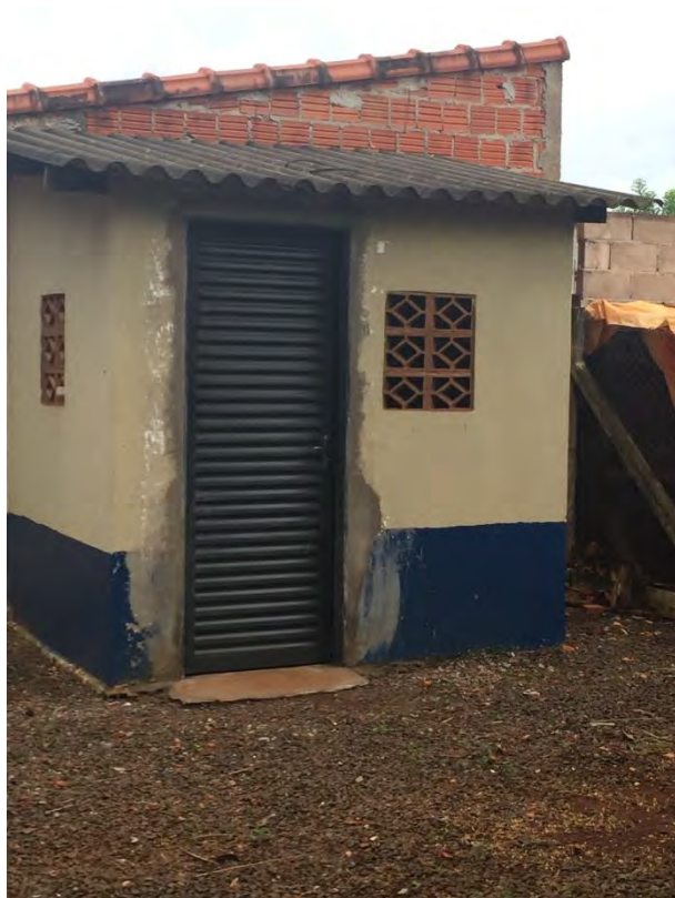
Casa de abrigo para quadro de comando
