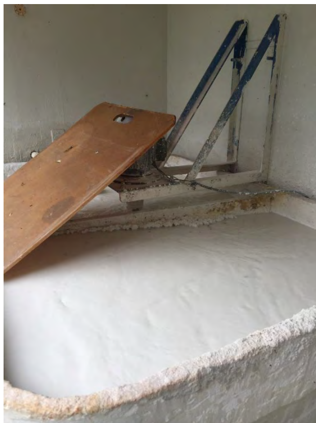
Figura 9: Tanque de preparação de solução de cal
