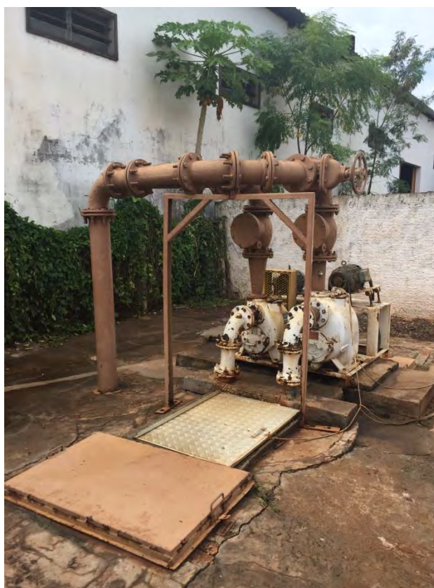
Vista do gradeamento, poço de sucção, conjuntos motobomba e barrilete de recalque
