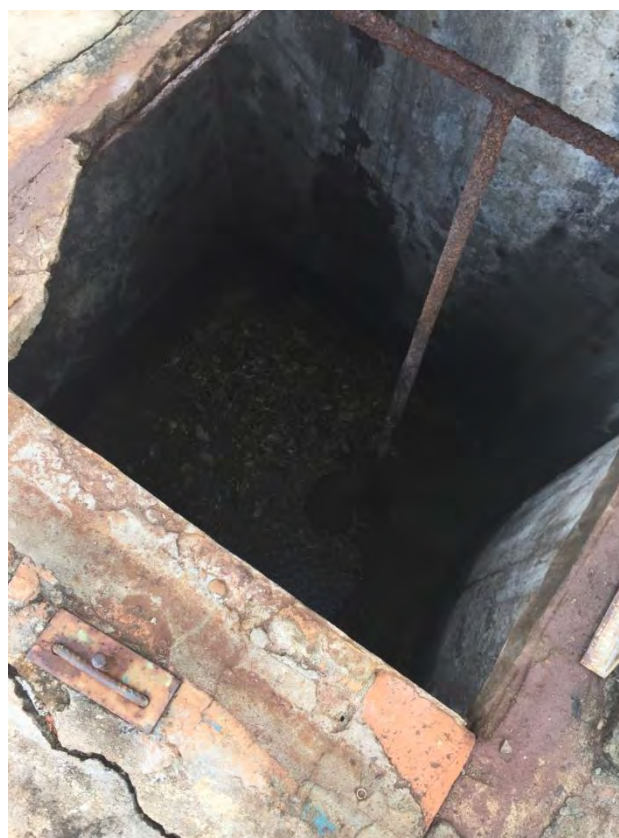
Acúmulo de sólidos no poço de sucção
