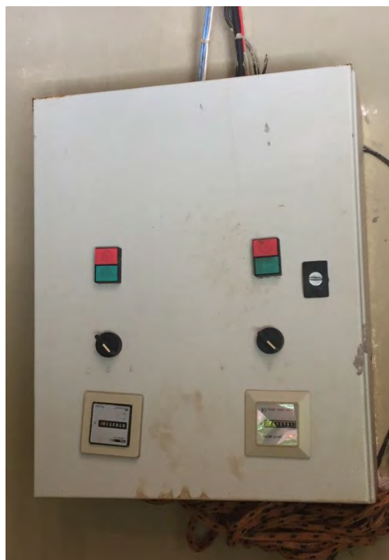
Quadro de comando
