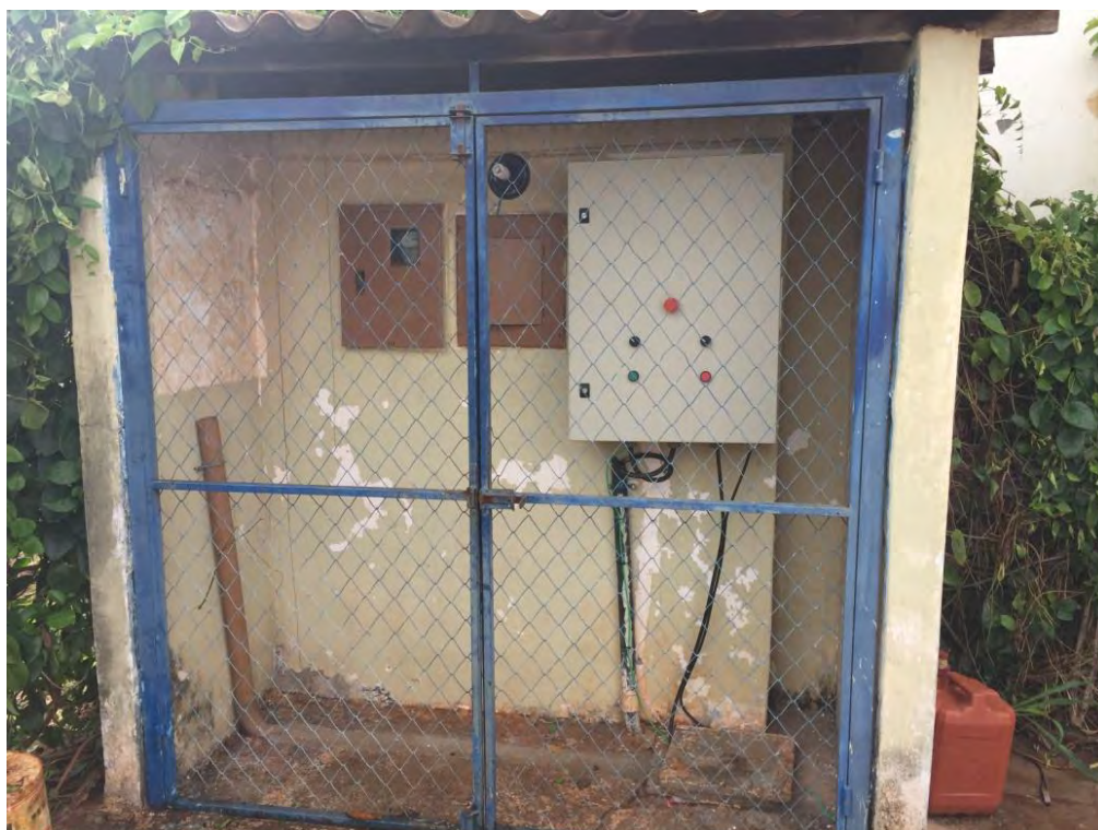
Abrigo do quadro de comando
