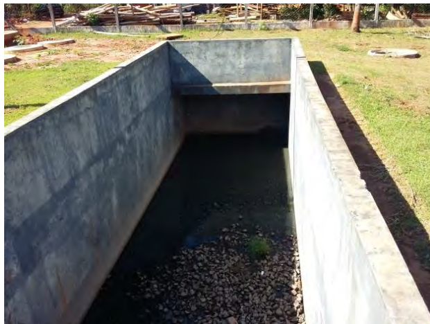
Figura 15: Tanque Séptico, ETE Jateí.
