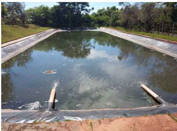
Figura 17: Vista 1 - Lagoa Facultativa, ETE Jateí.
