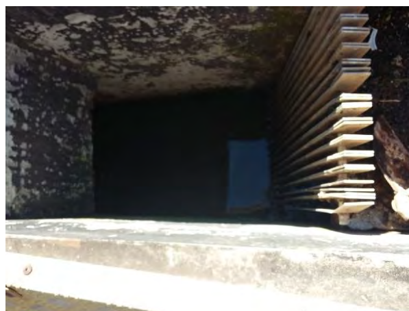
Figura 11: Gradeamento Fino, ETE Jateí.
