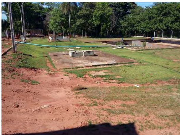
Figura 21: Geral Urbanização, ETE Jateí.
