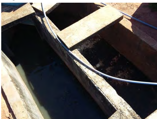
Figura 12: Desarenador, ETE Jateí.
