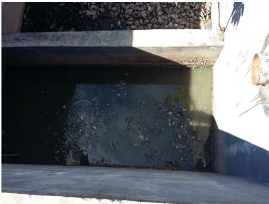
Figura 16: Filtro Biológico, ETE Jateí.
