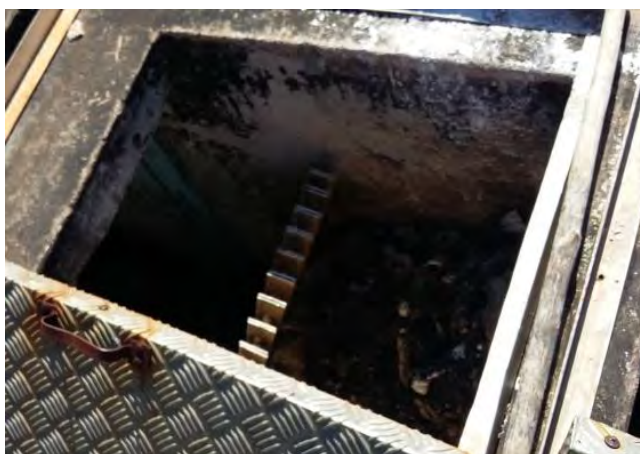
Figura 10: Gradeamento Grosso, ETE Jateí.
