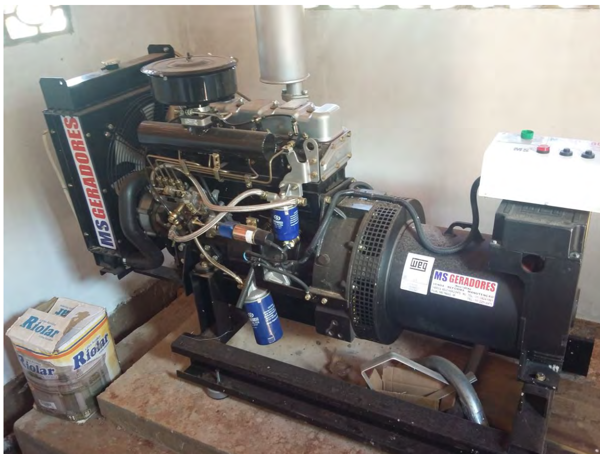
Figura 31: Grupo Gerador, ETE Jateí.
