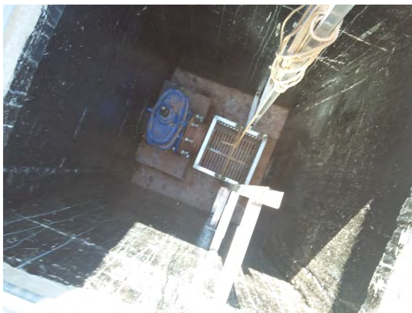
Figura 30: Novo Cesto retentor de Sólidos, ETE Jateí.
