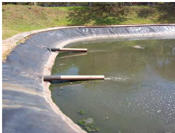
Figura 18: Vista 2 - Lagoa Facultativa, ETE Jateí.
