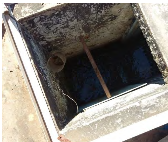
Figura 9: Caixa de Entrada, ETE Jateí.
