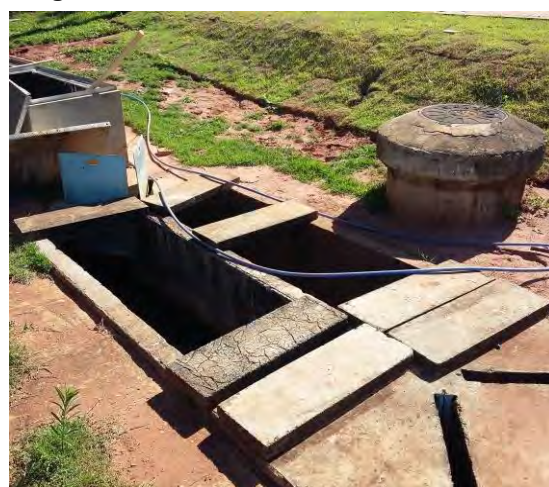
Figura 13: Desarenador e By-pass, ETE Jateí.
