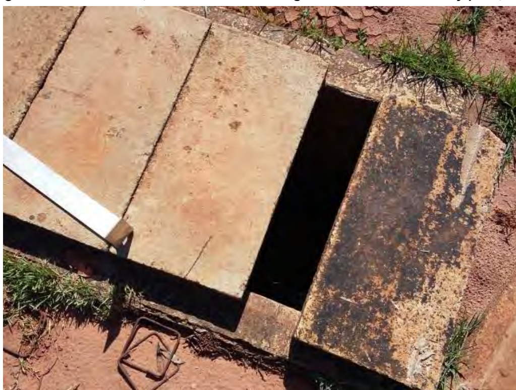
Figura 14: Canal onde está instalada a Calha Parshall de W=3", ETE Jateí.
