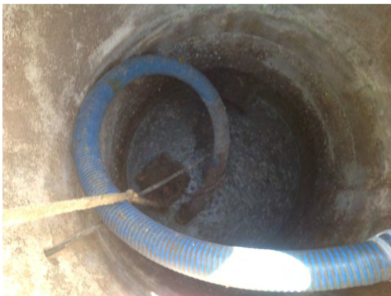
Figura 17: Poço de recirculação do líquido de descarga da caixa de areia
