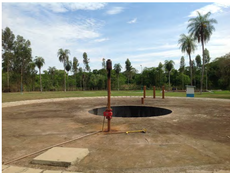
Figura 34: Queimador e válvula corta fogo
