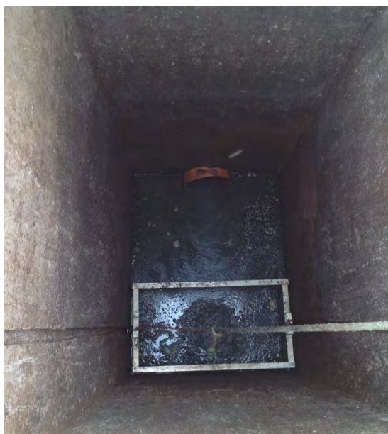
Retenção de sólidos grosseiros - cesto metálico
