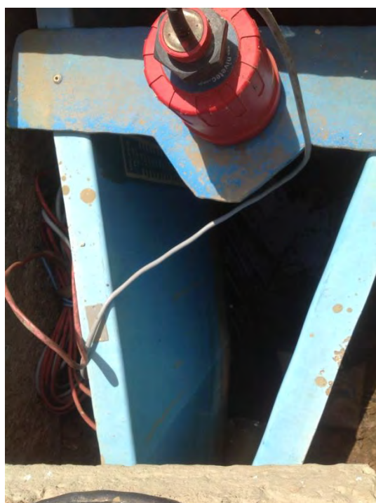
Calha Parshall e medidor de vazão
