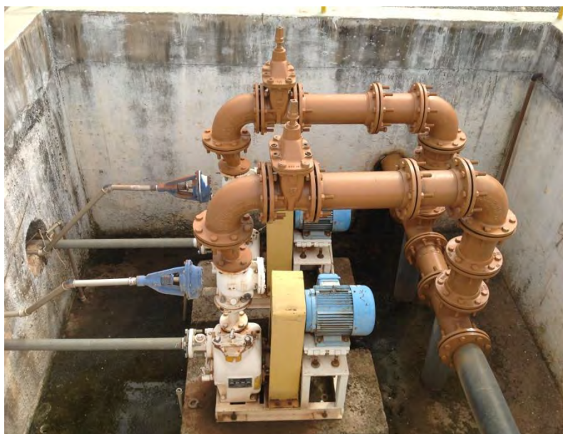
Conjuntos motobomba e barrilete de recalque
