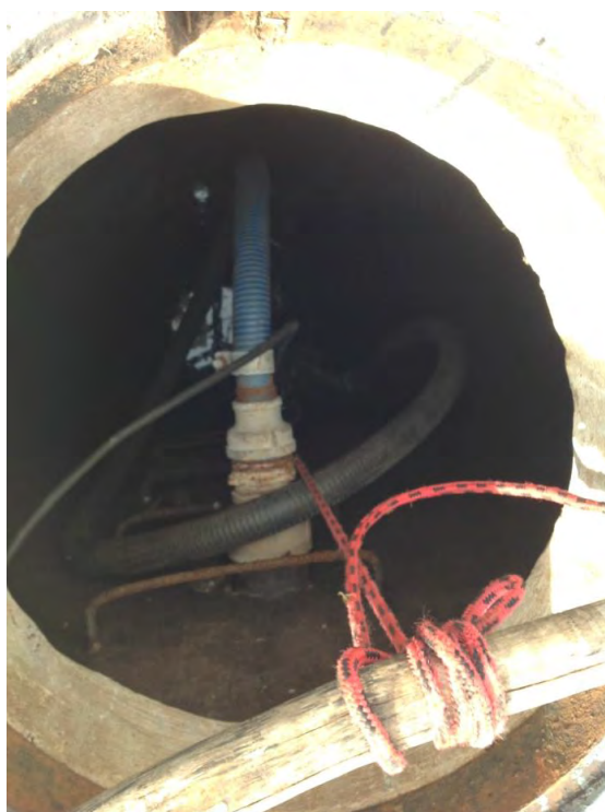
Figura 35: Estação elevatória de lodo
