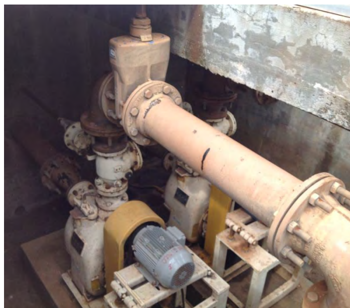
Barrilete e conjuntos motobomba
