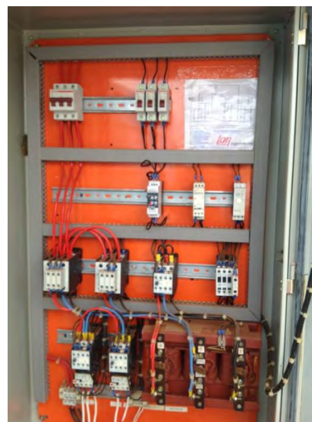
Quadro de comando
