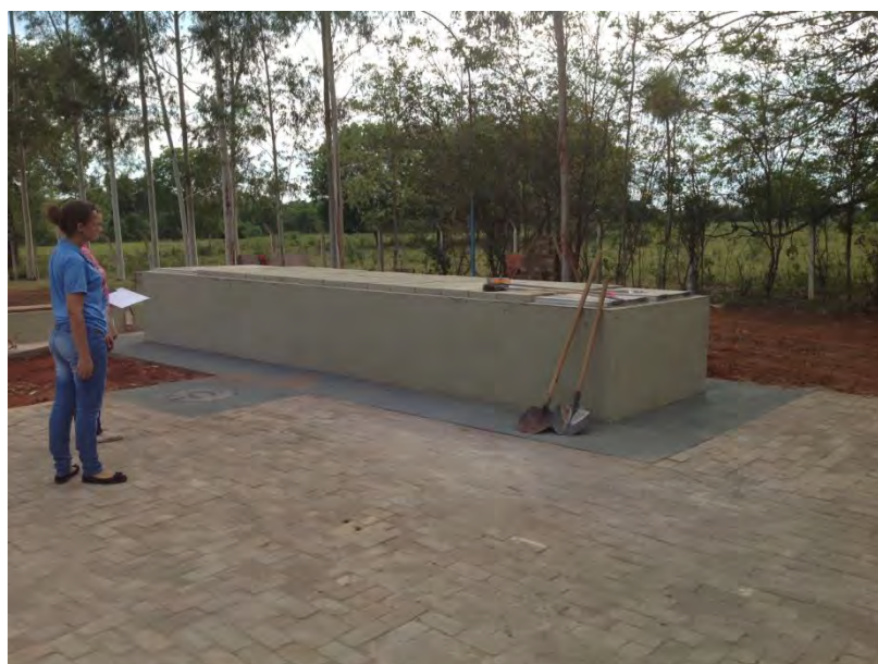
Figura 39: Estrutura para receber resíduos de auto fossa
