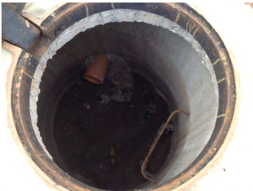
Figura 31: PV de saída - caixa de areia
