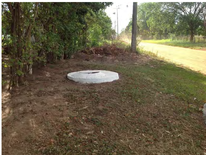
Figura 28: PV de entrada da ETE Centro
