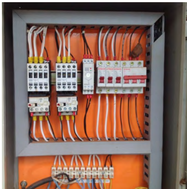
Quadro de comando
