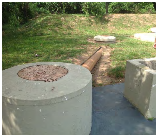
PV de entrada/ Extravasor - EEEB Cachoeirinha
