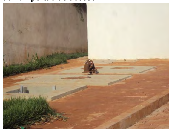
Figura 7: EEEB – 001 de Douradina, caixa do cesto coletor e poço de sucção.
