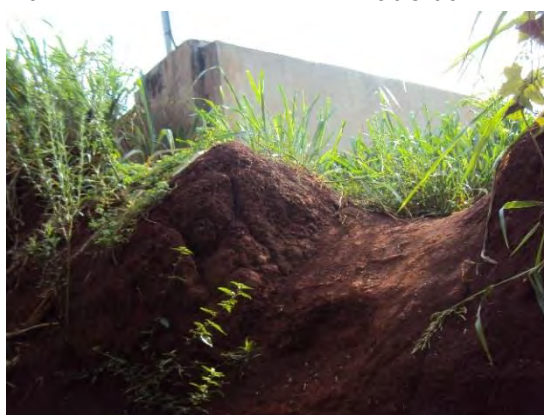
Figura 15: Vista da erosão - EEEB 002 em Douradina.
