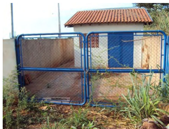
Figura 10: Portão de acesso e abrigo de quadro de comando da EEEB 002 em Douradina.
