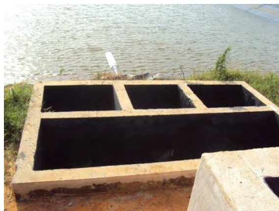
Figura 24: Caixa divisora de vazão na entrada na lagoa anaeróbica da ETE Douradina.
