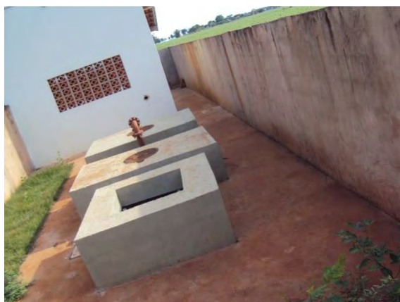
Figura 11: Caixa do cesto coletor, poço de sucção e caixa de barrilete na EEEB 002 em Douradina.
