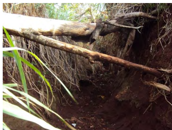
Figura 14: Detalhe da erosão existente ao lado da EEEB - 002 em Douradina.
