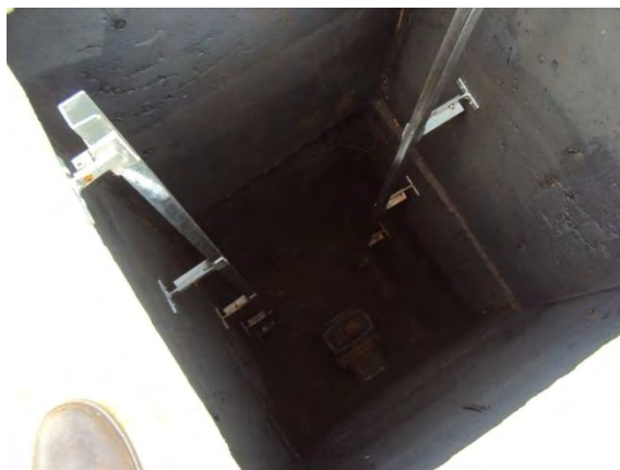
Figura 16: Caixa do cesto da EEEB 003 Final em Douradina.
