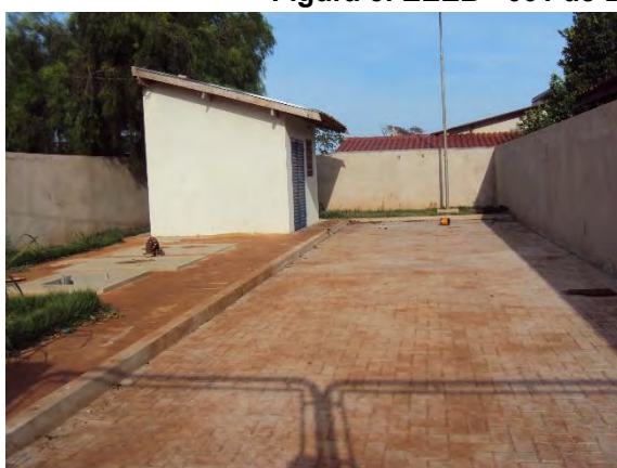
Figura 6: Abrigo de quadro de comando e urbanização da EEEB 001 de Douradina.
